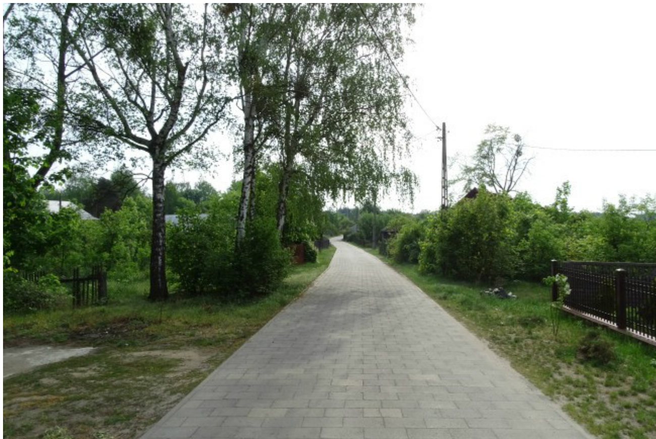
8. Remont odcinka drogi gminnej w miejscowości Słowiki Stare - Leśna Rzeka, o szerokości 4 m" Koszt zadania: 65 000,00 zł
